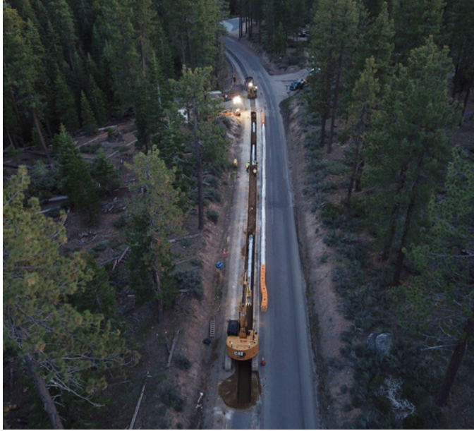
IVGID Effluent Pipe
